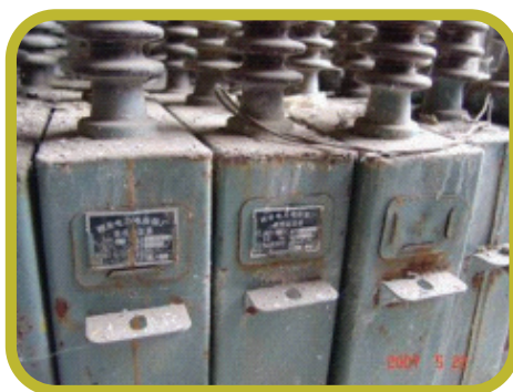
含多氯联苯电力电容器和变压器破损渗漏
