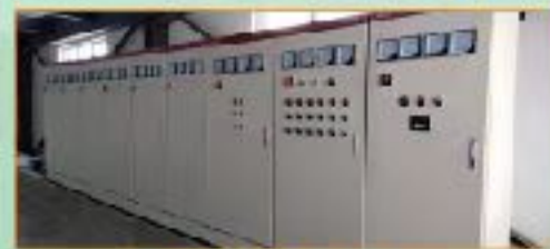
空气源热泵机组控制室
