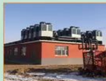
安装在锅炉房屋顶的空气源热泵机组
