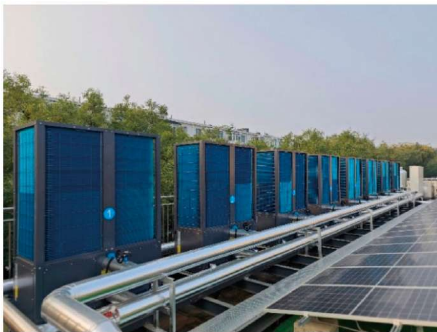
校园屋顶空气源热泵及光伏发电设施
